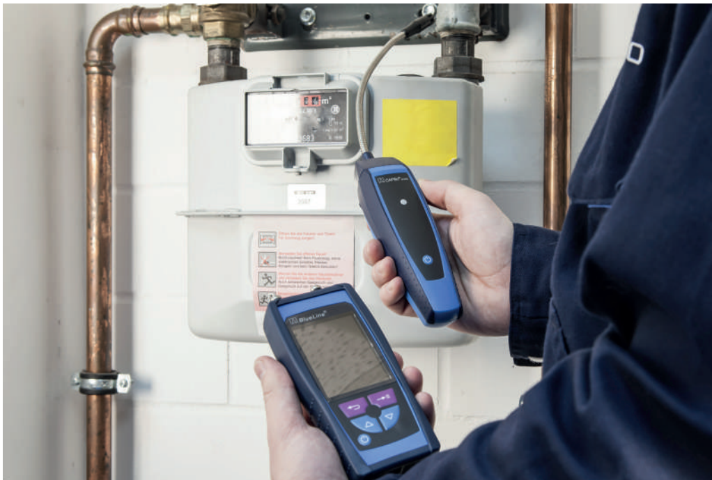
Exemple de détection de fuite de gaz avec la tête GS10
